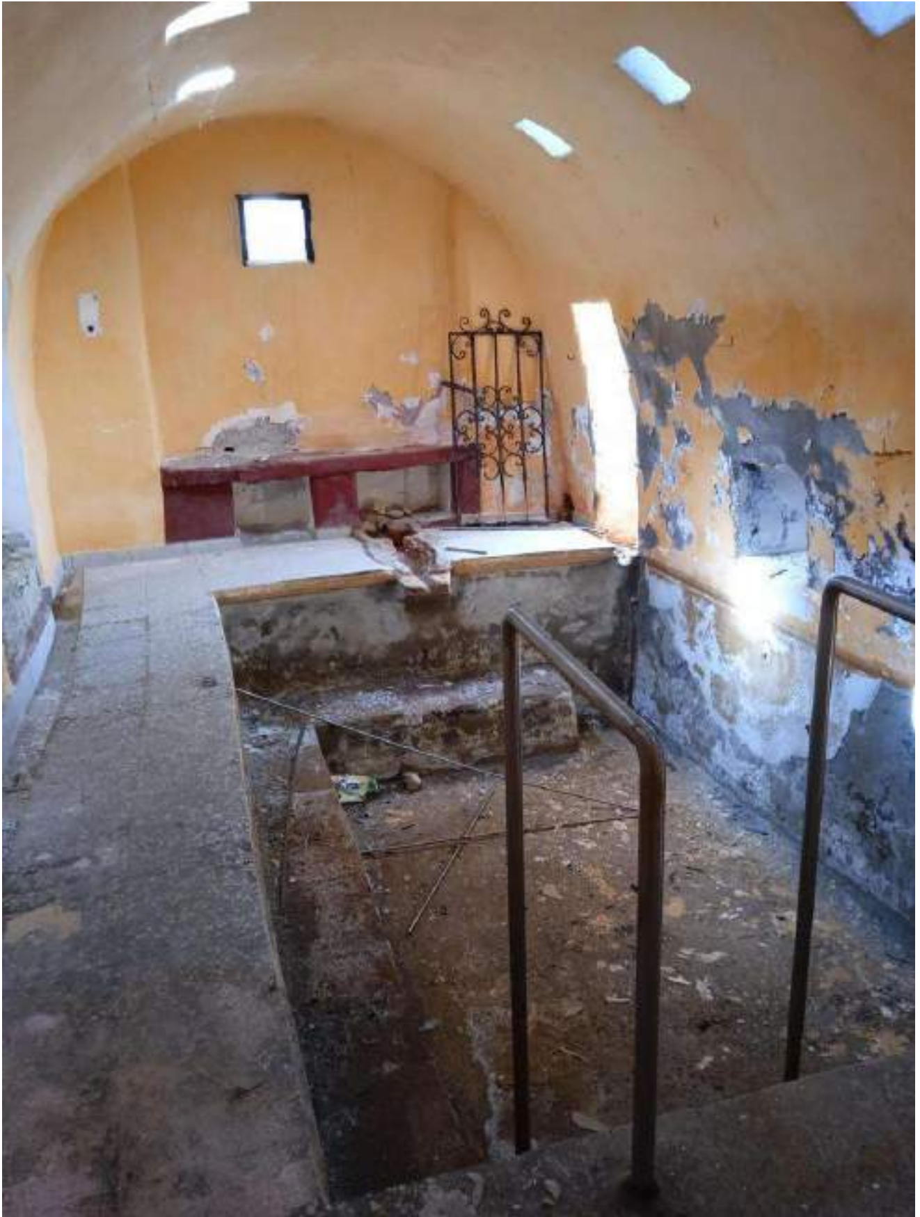
Ακίνητο Β, εσωτερικό λουτρών (δεξαμενή β)
